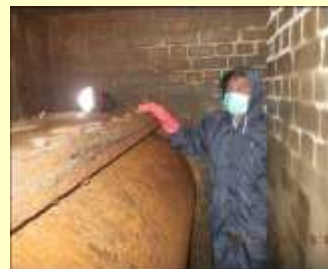
120年前布設の老朽化した圧送幹線
