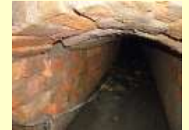
フランス統治時代整備の老朽下水管
